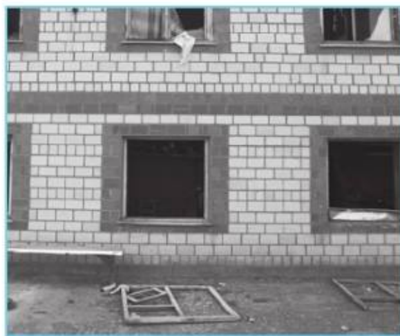
Последствия взрыва склада боеприпасов
